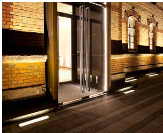
Abb.: Wallwasher mit verstellbarem Winkel strahlen die alten Mauern von unten an. Die Glasabdeckung über der »LED Drainlight« sorgt dafür, dass weder Schmutz noch Laub die Lichtqualität beeinträchtigt.
